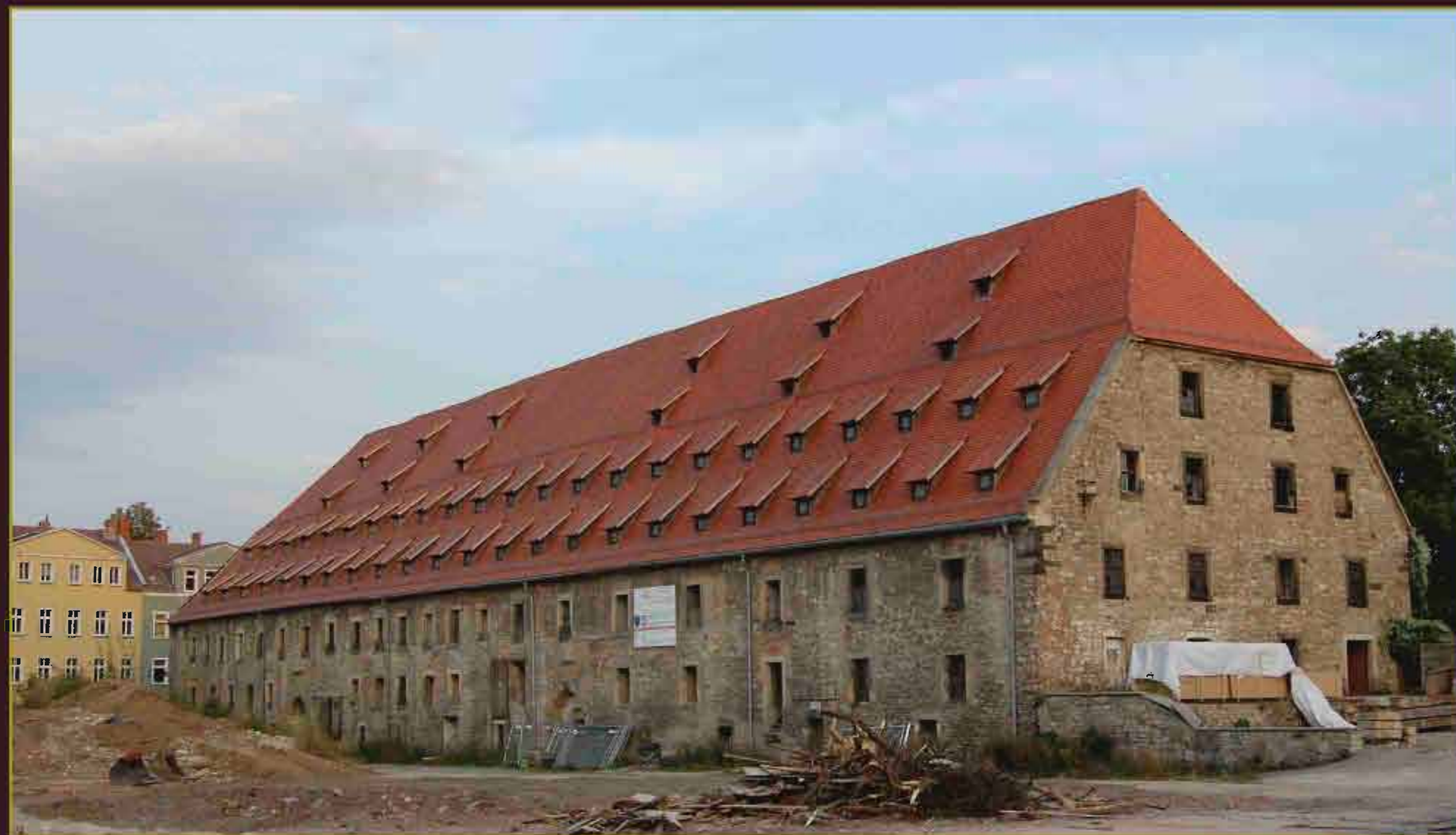
אסם הייסה הנטל לן חומה ה-19 במיור: עבודת השיחור The large 15 th century granary during restoration
